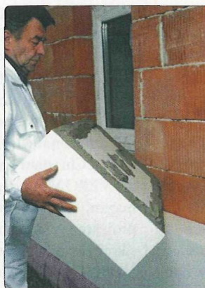
WDVS müssen von Profis montiert werden, um Mängel zu verhindern.
